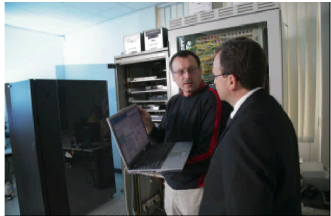
Im Rechenzentrum Kipper: Gerhard Kugland erläutert das Backup-Szenario!
