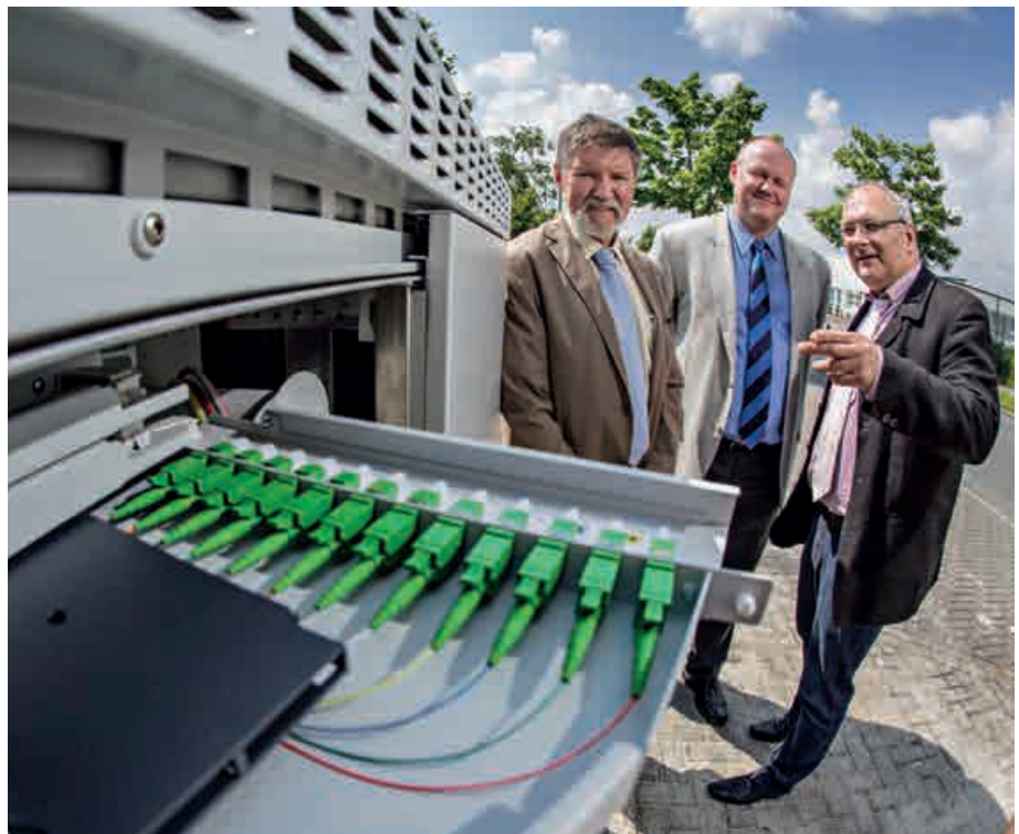
Ingo Totzauer, tech. Leiter der TMR erläutert die LWL-Technologie am Kabelverteilerschrank im Gewerbegebiet Friedrich d. Große
